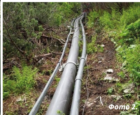
Фото 2. Підвідний трубопровід МГЕС
